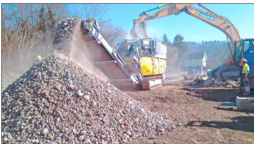
Dieser mobile Raupenbrecher mit selbstfahrender Siebanlage wurde im Jahr 2010 in Betrieb genommen.
