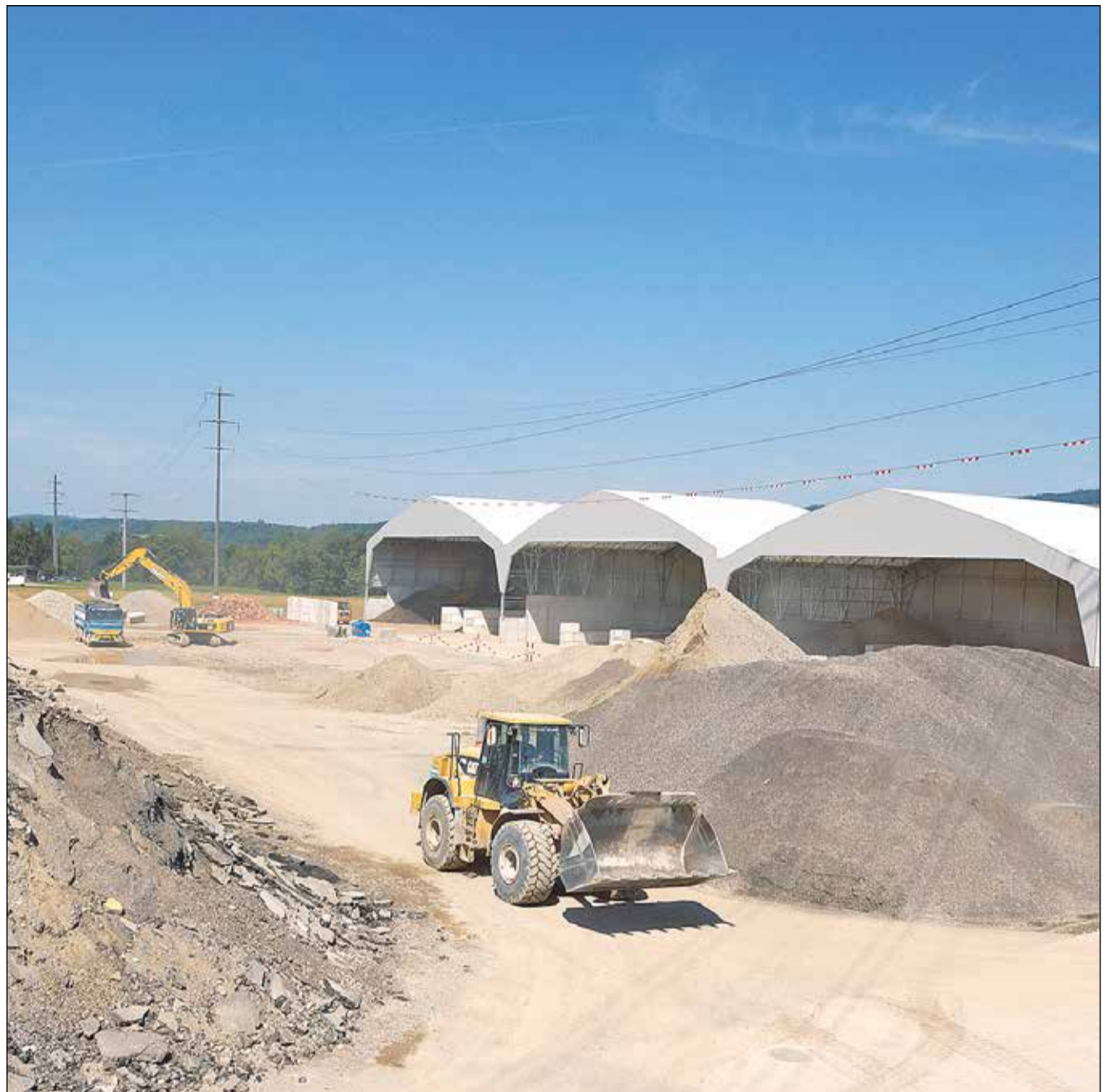
Mit der hochmodernen Recyclinganlage verfügt Hubschmid über die gesamte Wertschöpfungskette beim Rückbau.
